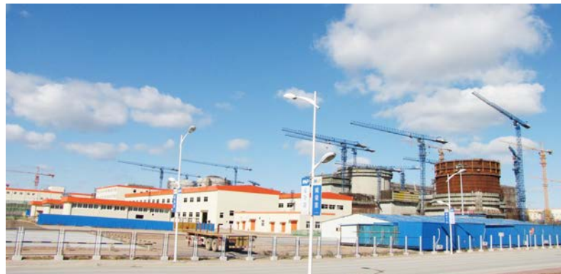
六月。东北首座核电厂——辽宁红沿河核电站1号机组完成168小时试运行投入商业运行,标志着我国东北地区首座、纬度最高、自主创新最多、国产化率最高的核电站并网成功。中建电力参建。
