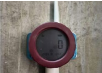
電梯基坑智慧水浸監測報警系統
