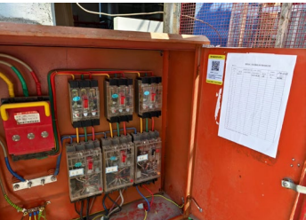
配電箱二維碼巡檢系統
