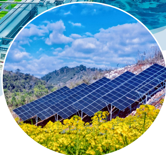
云南省耿马县东老光伏发电项目
